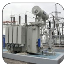
Объекты энергетической отрасли
